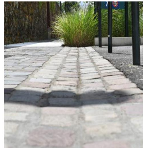
CANIVEAU INFILTRANT RUE SŒUR VALÉRIE, VILLE D'ASNIÈRES.
