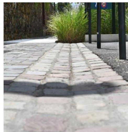
CANIVEAU INFILTRANT RUE SŒUR VALÉRIE, VILLE D'ASNIÈRES.
