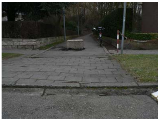
Foto 2 Boordsteen aan de ingang van het pad buiten het wegennet tussen de Elleboudtlaan en het zwembad Longchamp
